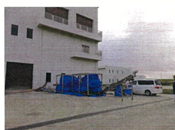
仮設汚泥 脱水機
