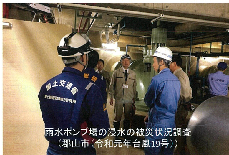
浸水の被災状況調査 (福島県 国見町(令和元年台風19号))
